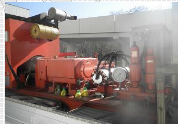
大型高圧ポンプ
